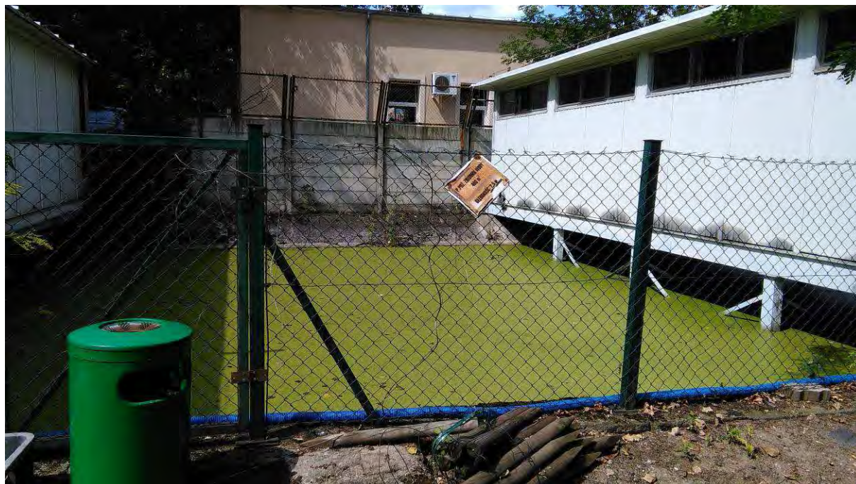
Rycina 29. Zanieczyszczony sztuczny zbiornik wodny na terenach przemysłowych
